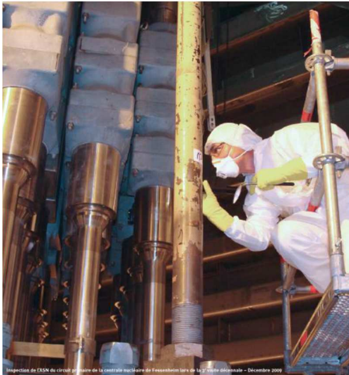
Inspection de l'ASN du circuit primaire de la centrale nucléaire de Fessenheim lors de la 2 e visite décennale - Décembre 2009
